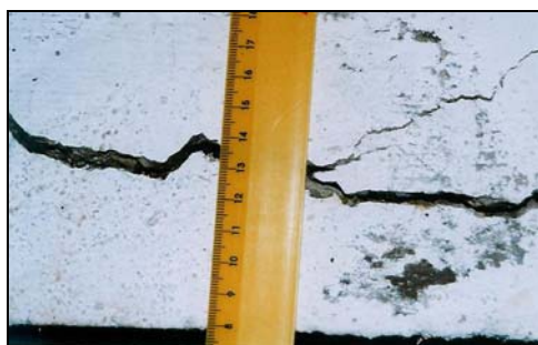
Fig. 6 - Degradação avançada de betão armado
