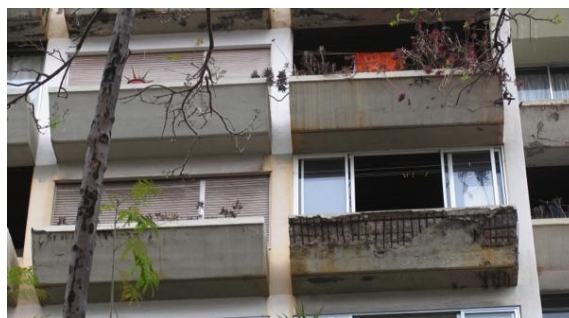
Figura 1 - Degradação acentuada de edifício
