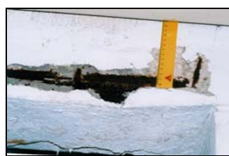
Fig. 2 - Destacamento da camada de betão
