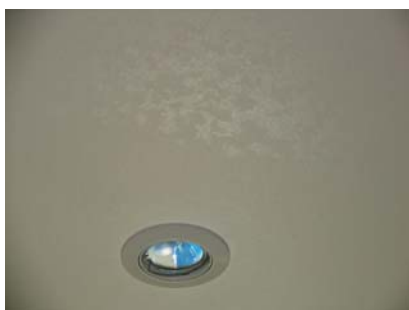
Fig. 6 - Condensação em tecto de casa de banho
