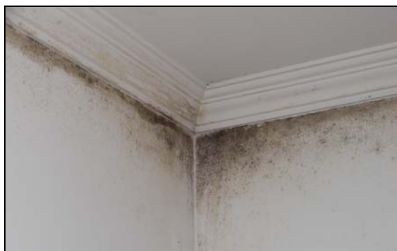
Fig. 7 - Bolor em paredes
